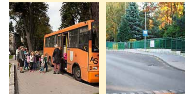
Budowa zatok autobusowych przy Szkołach Podstawowych nr 2 i nr 3 w Obornikach Śląskich
